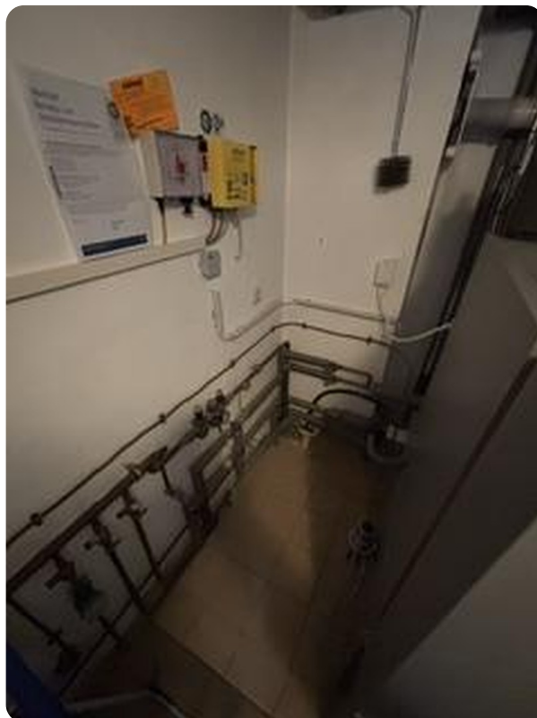
Anschlüsse Wasser und Heizung
